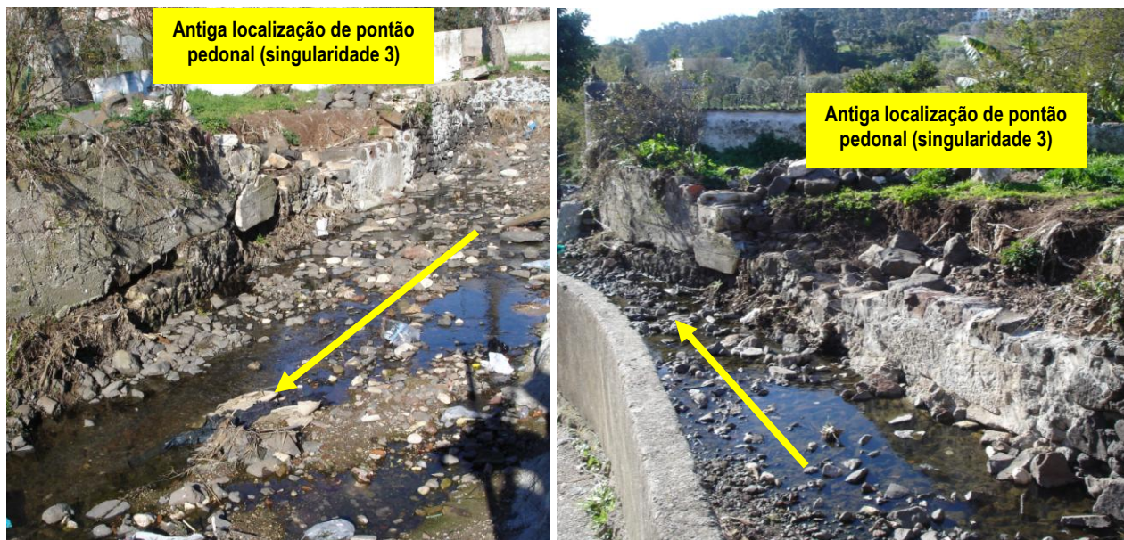
Figura 5.6 – Fotos do trecho final da Rib a de Massamá após as cheias de Novembro de 2011 (em Janeiro de 2012)
