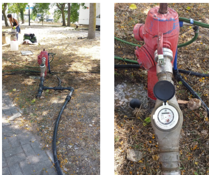
Figura 17 - Contador de água que abastece uma área de stands de restauração.
